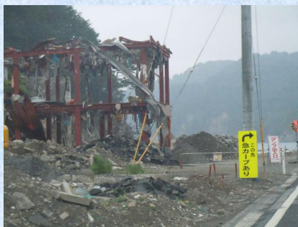
両石町 防潮堤が跡形もない
