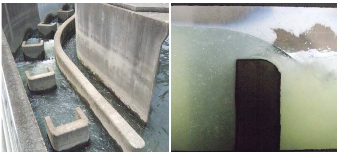
図 1 左：利根大堰の 1 号魚道の入り口，右：1 号魚道の側面にある観察窓
